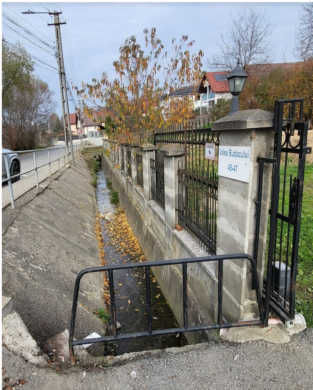
Imagine 5.22 Rigola str. Valea Budacului continuare rigolă str. Cocorului
